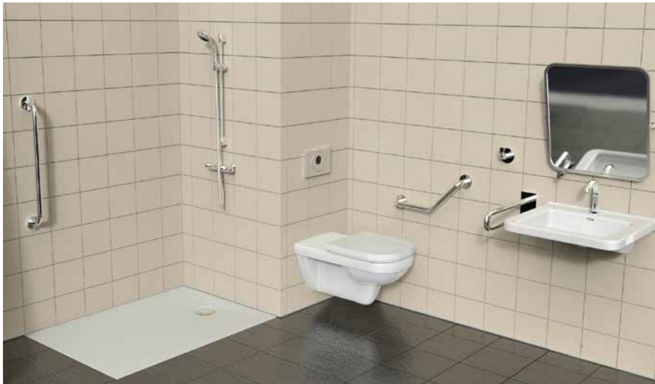
↑ Receveur de douche Olona avec bonde de douche Geberit, WC Renova Confort Square, lavabo Renova Square, commande électronique pour WC Sigma10 IR.
